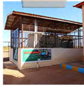
محطة تحلية DESALINATION UNIT
